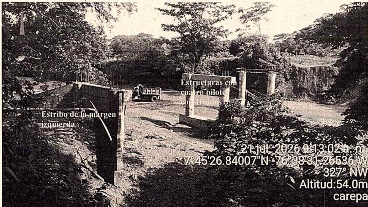
Foto 1: Estructura de la margen izquierda y dos estructuras con dos pilotes construidos sobre el cauce del río Carepa sin el debido permiso por parte de CORPOURABA.
