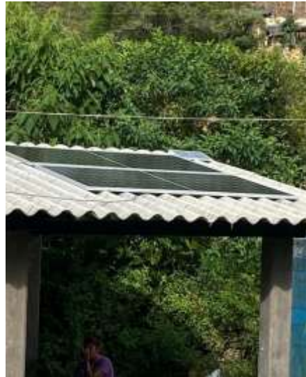
Imagen 35: Paneles solares instalados sobre la cubierta de la caseta comunal.
