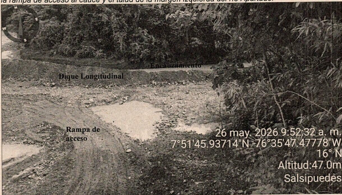
Foto 2: Se observa el dique longitudinal con material aluvial, el canal de encauzamiento y la rampa de acceso al cauce del río Apartadó.
