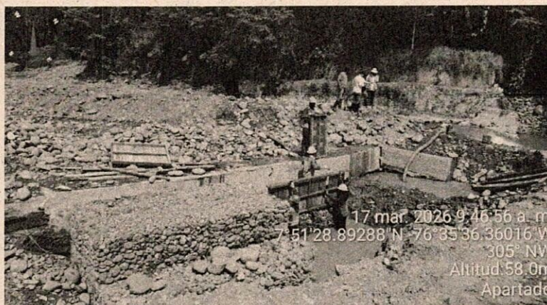
Figura 5. Obras de protección del acueducto municipal sobre el cauce del río Apartadó.
