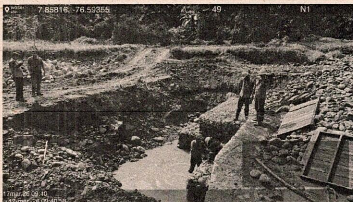
Figura 6. Obras de protección del acueducto municipal sobre el cauce del río Apartadó
