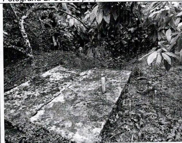
Fotografía 4. Pozo séptico de las cocheras
