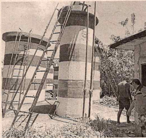
Fotografía 1. Ingreso por bombeo PTAR
