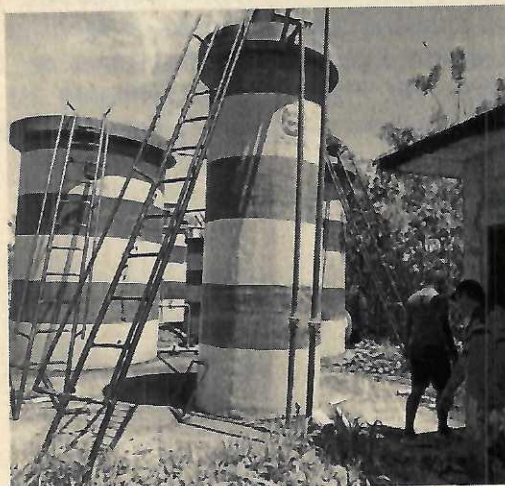
Fotografía 1. Ingreso por bombeo PTAR
