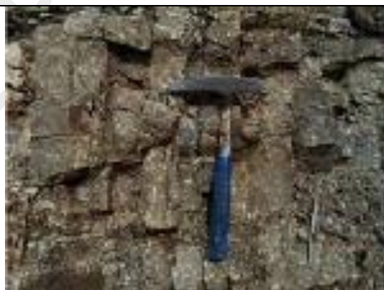
Figura 96. Macizo rocoso de los derrames diabásicos y basálticos de los Basaltos de El Botón, muy fracturado, con bloques angulosos formados por intersecciones de familias de discontinuidades, estación JAM-28, vía Nacional Medellín – Turbo, municipio de Frontino, vereda El Llano, coordenadas (1092264.9E - 1242571.3N).
