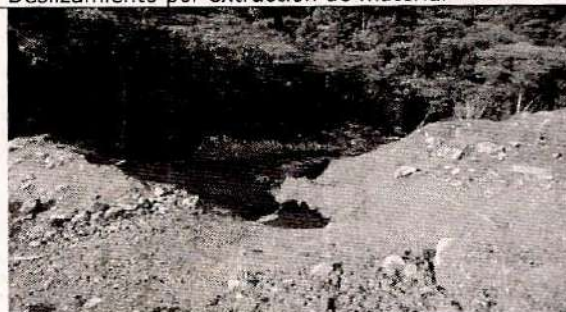
Derrumbe por socavacion de ladera
