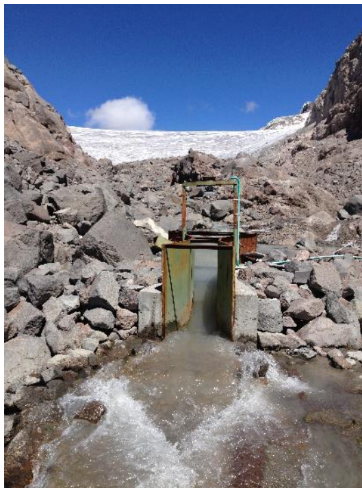
Figura 68. Canaleta Parshall, Parque Natural Nacional los Nevados. Fuente. Subdirección de Ecosistemas. IDEAM 2017.
