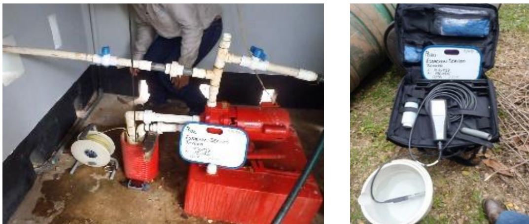
Figura 189. Medición in situ con un medidor multiparámetro en un pozo profundo de extracción.
