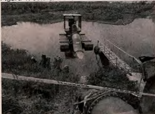
Figura 3. Estación de bombeo: 124hp
