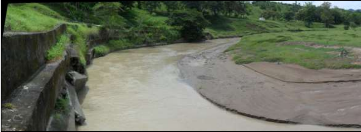
Figura 101. Socavación lateral margen derecha río Guadualito – Caracolí. Fuente: Elaboración propia
