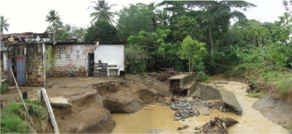
Figura 3. Afectación de infraestructura por quebrada la Anguilla. Fuente: Corpouraba, 2011
