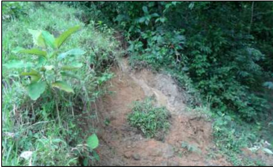
Figura 18. Evidencian algunos procesos de movimientos en masa de magnitud importante Deslizamiento – Hacienda Currulao, estación EG-05 SECTOR ESCUELA HACIENDA CURRULAO (Fuente: propia).
