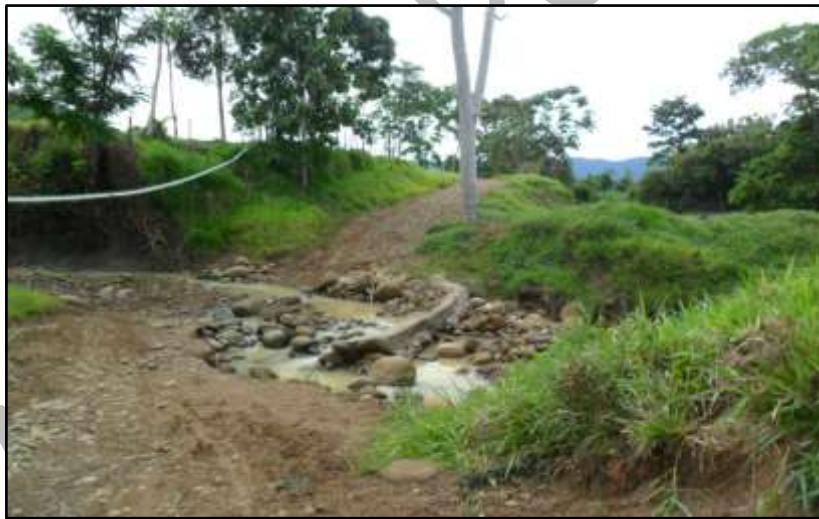
Figura 17. Estado de la vía Nuevo Antioquia – Playa Larga afectada por movimientos en masa (Fuente: propia).
