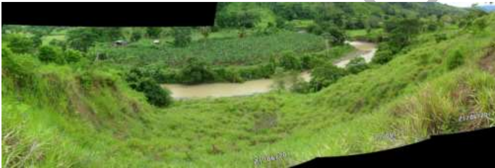
Figura 97. Deslizamiento en la margen derecha del río Currulao, sector Playa Larga. Fuente: Elaboración propia.
