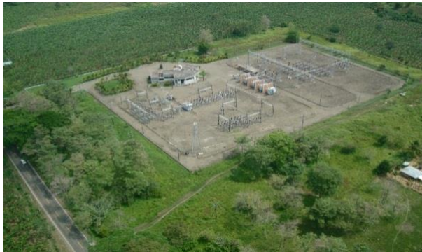
Figura 14. Panorámica de la subestación El Tres. Fuente: Google Earth (2017).
