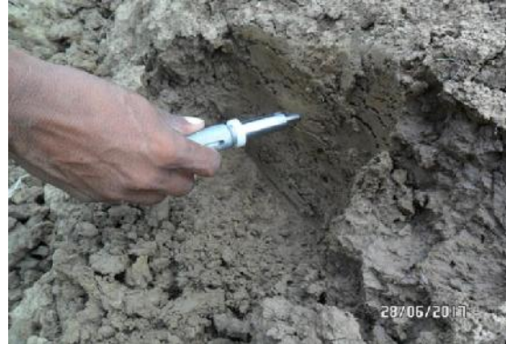
Figura 100. EG-33 Talud superior vía, socavación Caimán Viejo. Prueba con penetrómetro en arcillas con resistencia residual (1039189E – 1415538N). Fuente: Elaboración propia.
