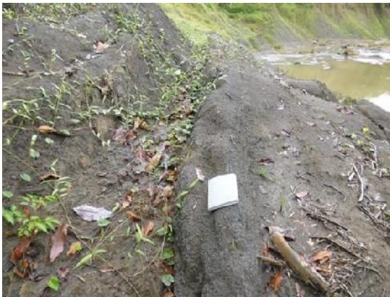
Figura 67. Capas de lodolita con alta meteorización. Coordenadas 1394790.33N, 718441.037E Fuente: Elaboración propia.
